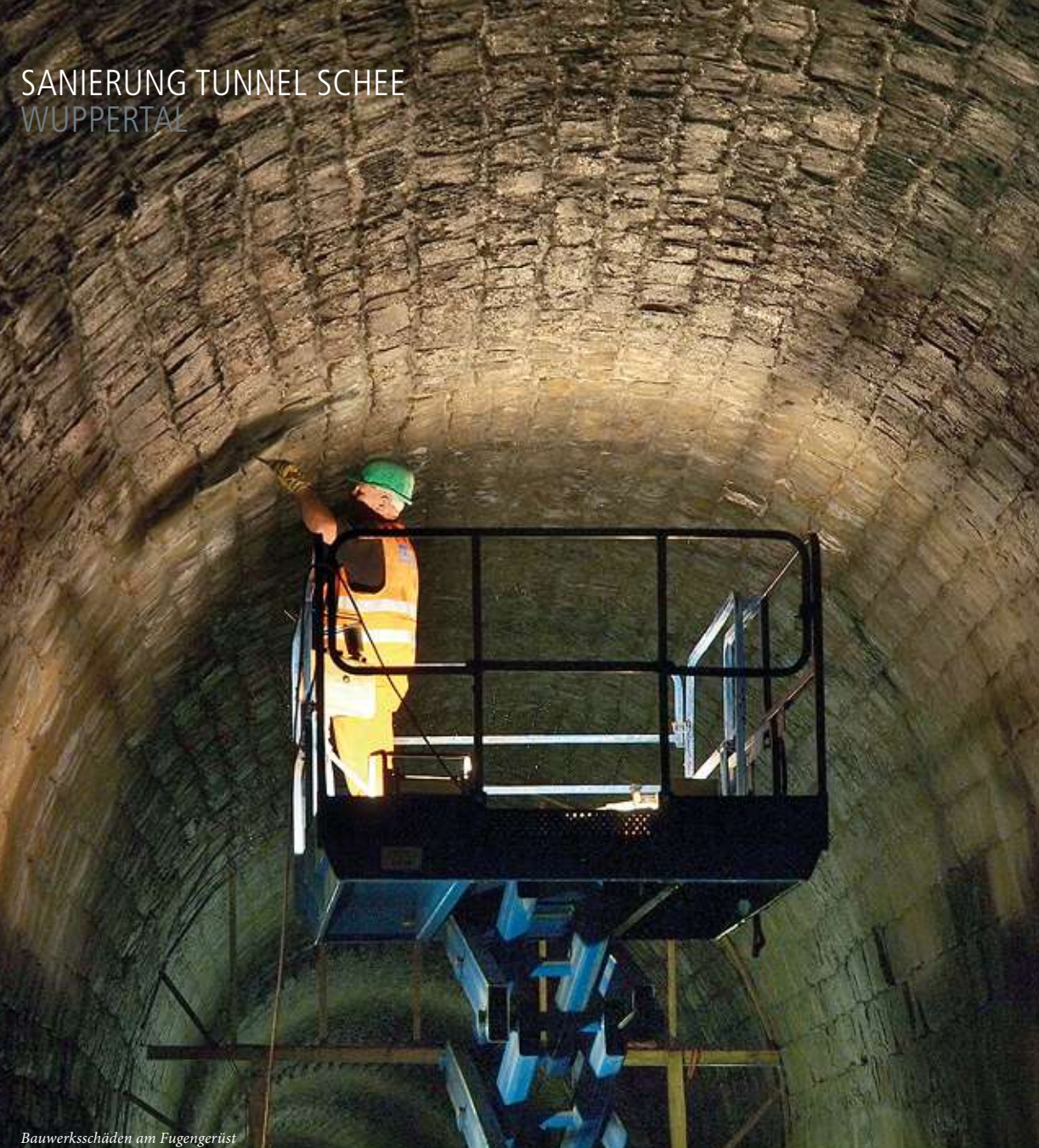
Bauwerksschäden am Fugengerüst
