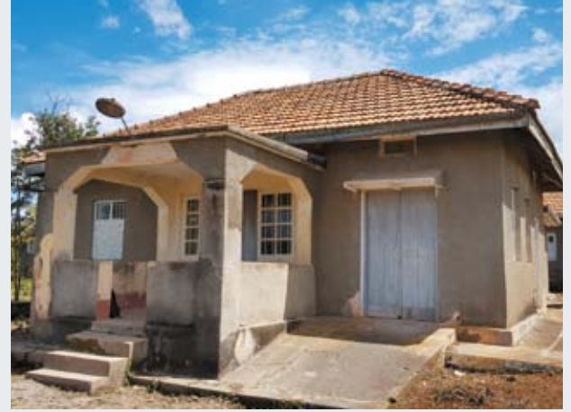
Das Klinikgebäude muss dringend saniert werden.
